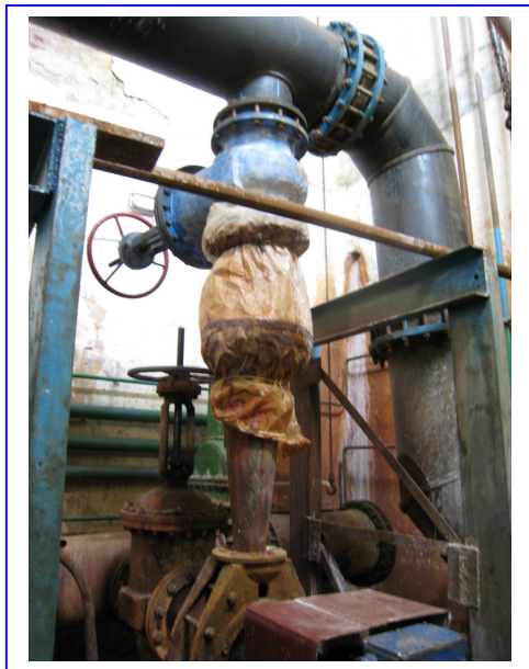
Zu verbessernde Arbeitsbedingungen in der Kalkmilchaufbereitung
