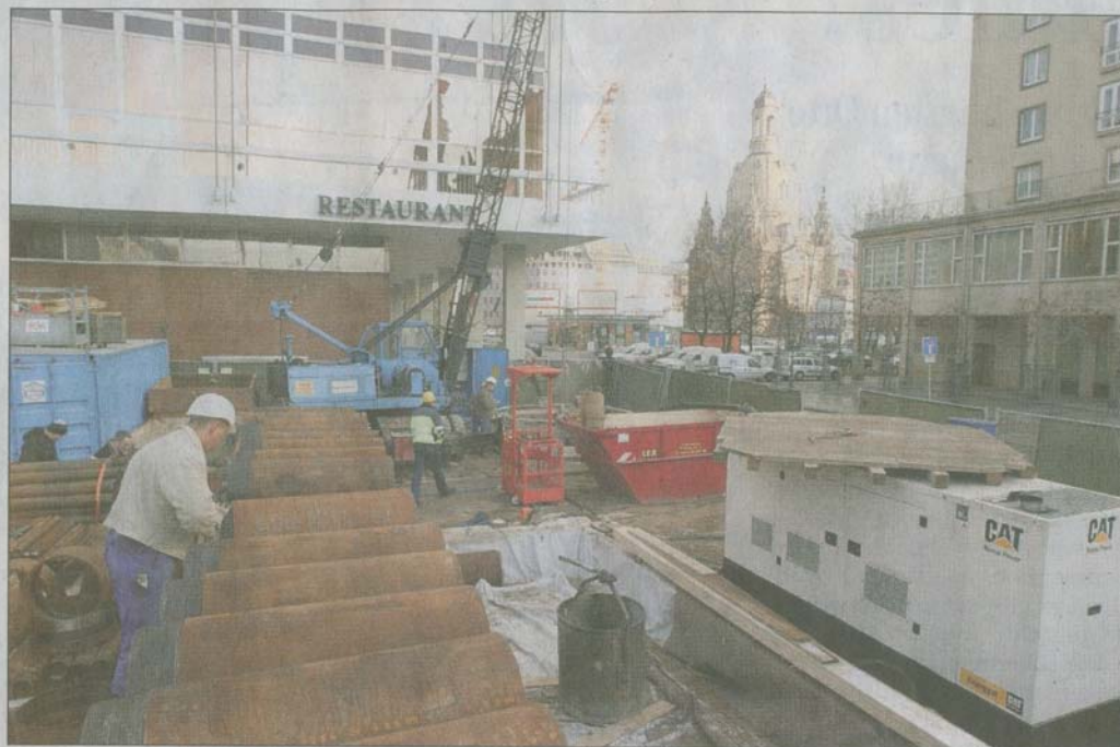
Beim Bau eines Horizontalfilterbrunnens vor dem Kulturpalast in Dresden. Dieser Brunnen entstand für die Zentrale Kälteversorgung aller Hotels um die Frauenkirche herum.
