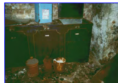
Öllager mit MKW-kontaminierten Fußboden- und Wandbereichen
