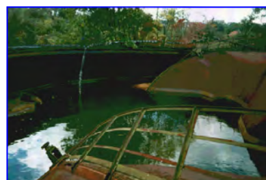
Gasbehälter, mit eingebrochener Stahlhaube
