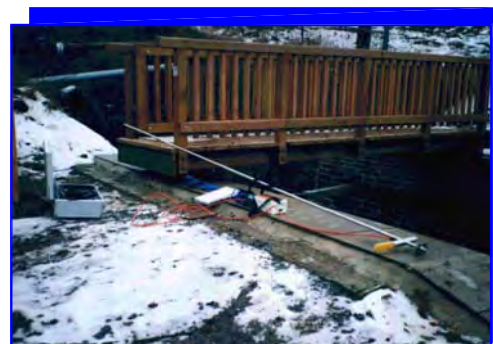
Aufnahme Geschwindigkeitprofil mit induktivem Strömungssensor
